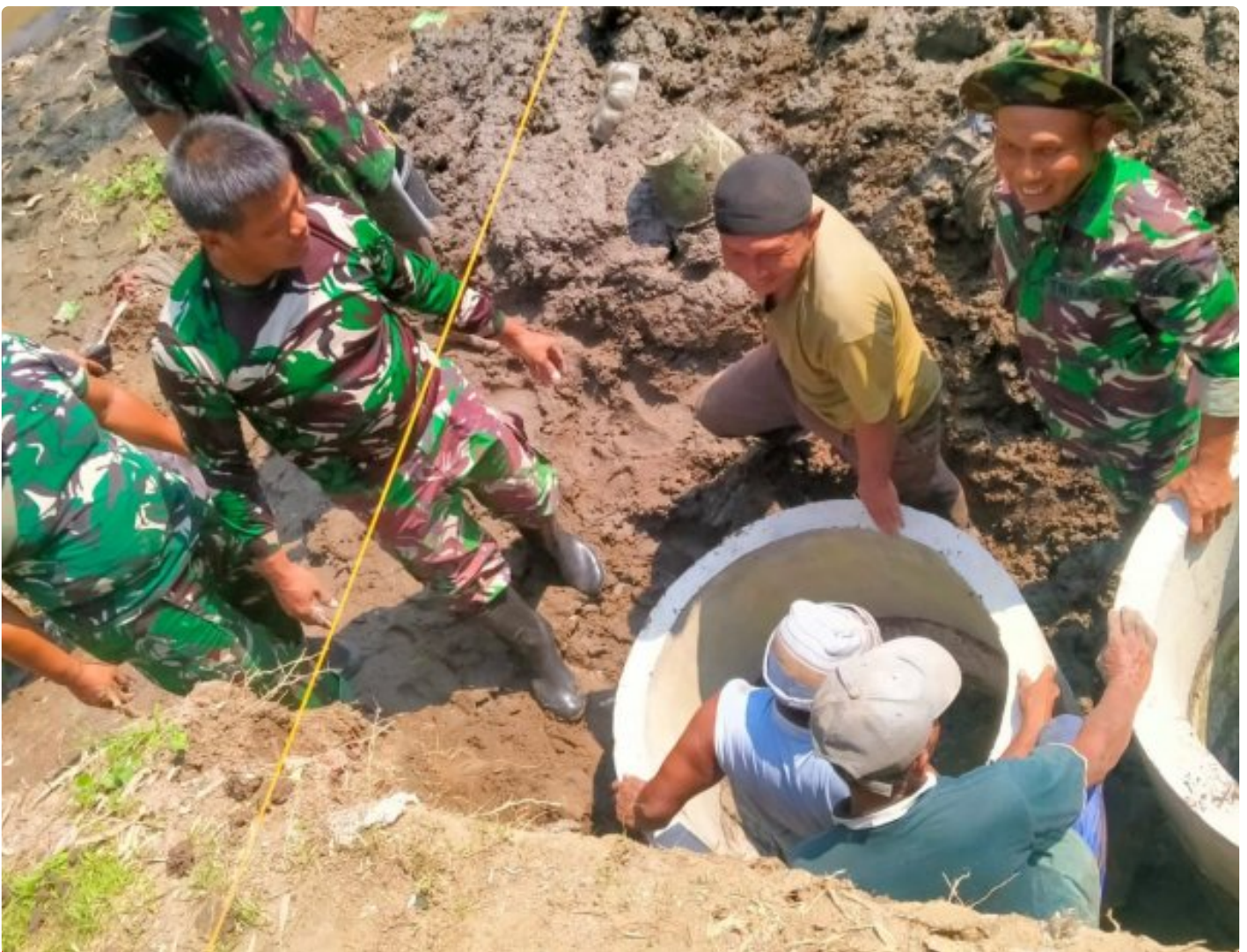
Pembangunan Jembatan Garuda Di Desa Burikan Masuki Tahap Pemasangan Bis Beton Pondasi
